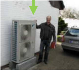
Quelle: Kritsch Haustechnik
